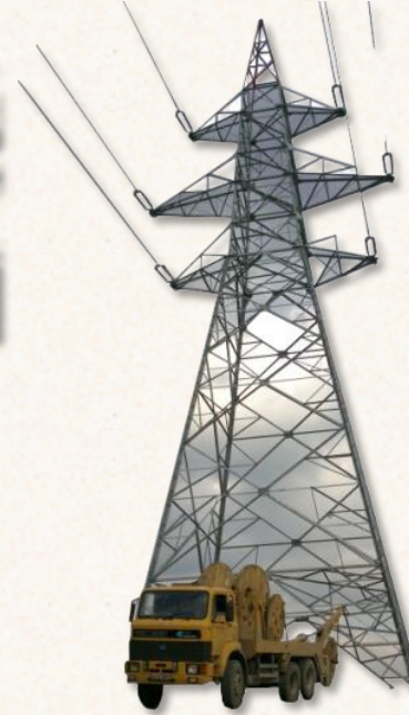
Enerji İletim Hatları Over Head Lines
